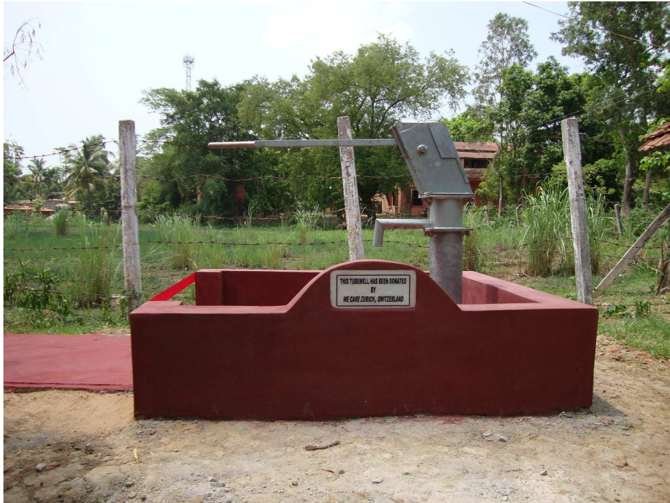
Die neue Wasserpumpe auf dem Schulgelände
